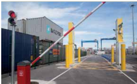
Portal espectrométrico de detección de radiación
